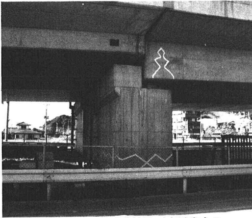
(a) 橋脚基部の曲げ破壊及び支承直上の コンクリート桁の破壊（ともに幅5cm）
