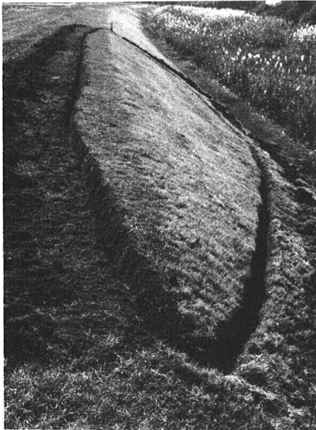
(a) 幅10cm, 深さ20cmにVカットし 堤体クラックを表わしたもの
