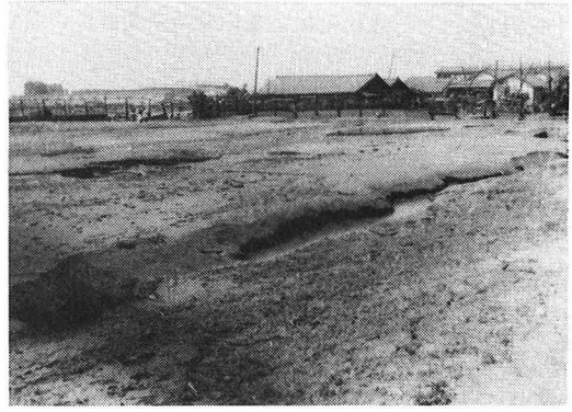
写真2 地点Bのグラウンドに生じた亀裂
