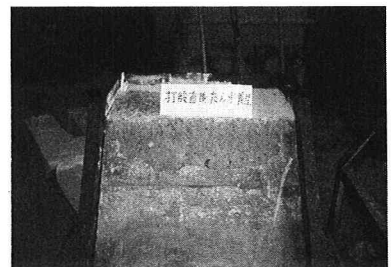
写真-2 湛水養生の影響
