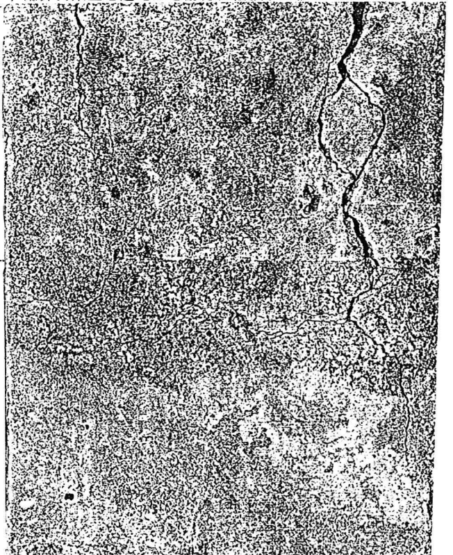
図-6 複合せん断強度低下をもたらす板状ひびわれ
