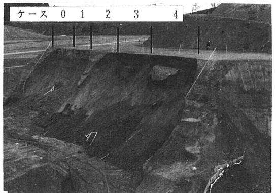
写真-1 盛土崩壊状況
