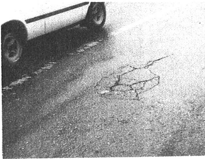
写真1 舗装のひびわれ状況
