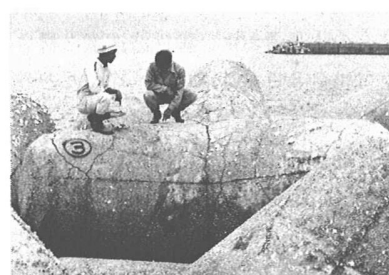
写真-1 AARによる損傷例 (テトラポッド)
