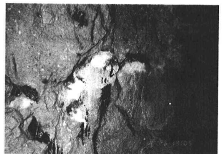
トンネル切羽の破碎
