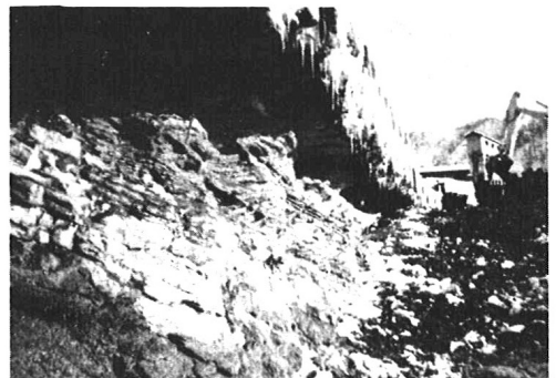
写真-1 北空知頭首工の下流護床工の損壊状況 (S.56年豪雨災・災害復旧事業概要書から)
