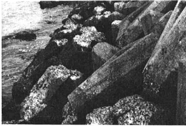
写真-2 骨材反応による コンクリートの劣化例
