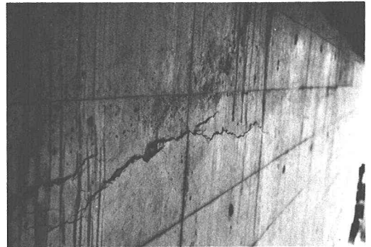
図-1 ひびわれ外観状況
