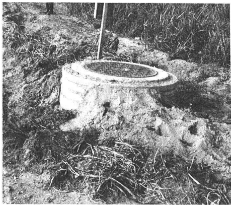
写真－1 マンホール浮上被害
