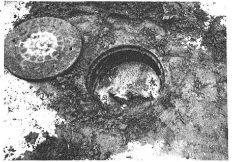
写真-1 マンホール内への土砂流入
