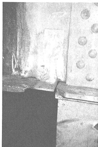
写真-2 端支柱上補剛桁腹板のクラック
