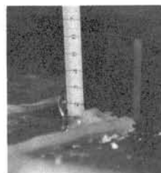
写真-8 写真-6のひびわれ上面に水を張って載荷試験を実施した時、ひびわれ面から水が噴出した。スケール前の透明の柱が水
