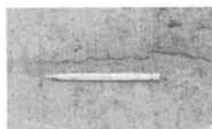
写真-5 未使用橋梁B橋 床版上面のひびわれ
