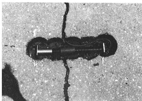
写真 アスファルト舗装に埋設した継目計
