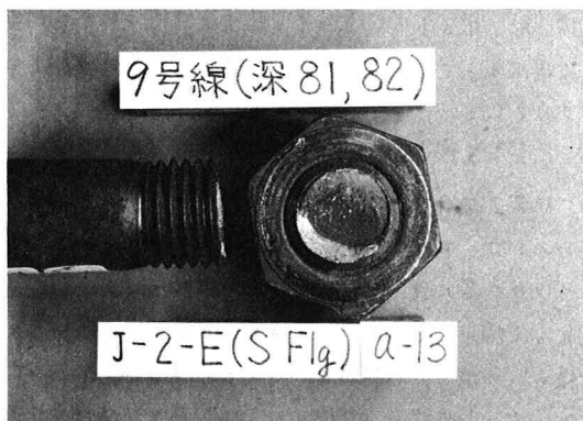
写真-1 破断ボルト(全断面が破断)
