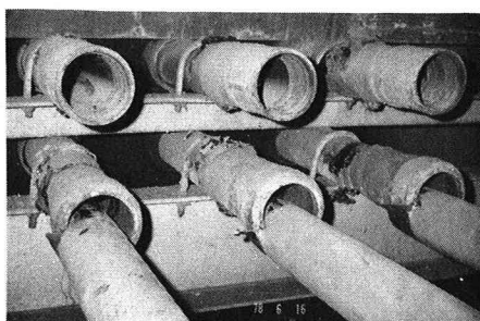
写真1 被害管路(橋梁架梁部)
