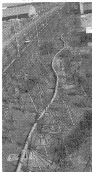
写真-1 ジグザグ配管の実施例
