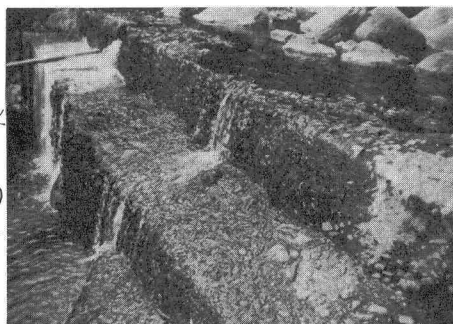
写真-2 浸食された床固め
