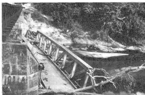
写真-3 内戦により破壊されたトラス橋と仮橋
