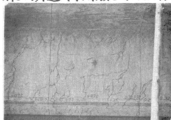
写真-1 ひびわれ状態1
