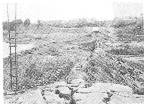
写真-7 早掛沼アースダムの欠壊
