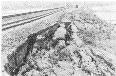
写真-5 東北本線盛土の崩壊
