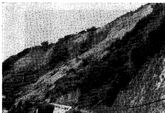
写真-6 落居地区の斜面崩壊
