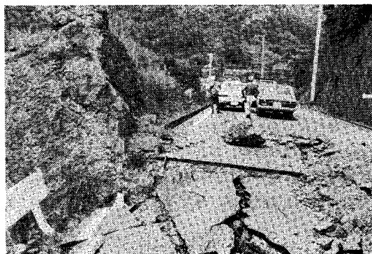
写真-8 盛土部の路面だけが被害を受けている中木付近の道路
