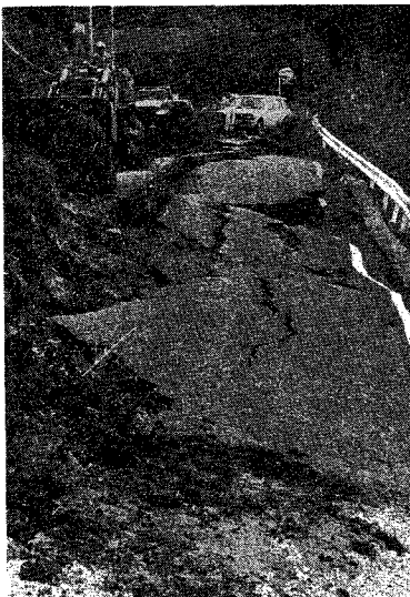
(盛土部分が被災している) 中木一石廊崎間の道路被災
