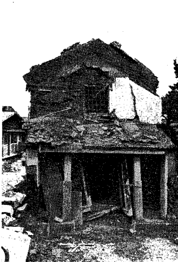
土蔵の多くはこのような被害を受けた・隣りの普通家屋は破壊していない
