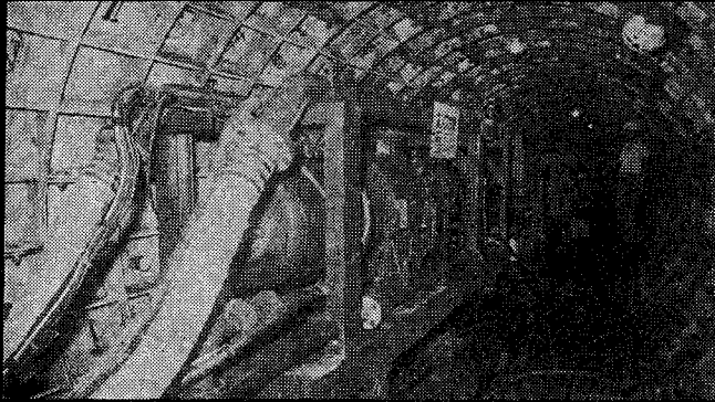
加圧送排泥設備(ポンプ台車)
