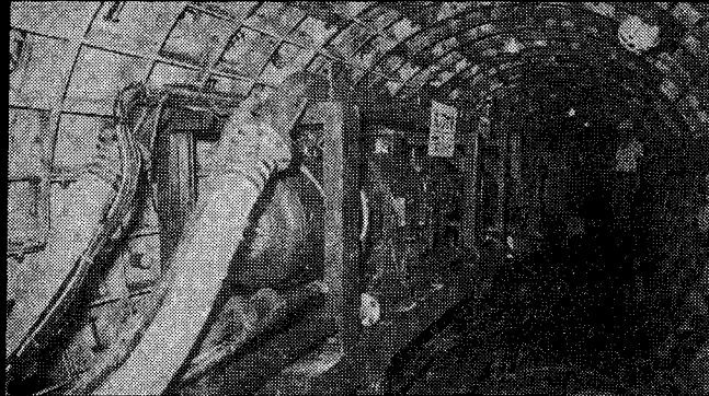
加圧送排泥設備(ポンプ台車)
