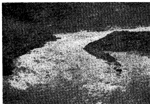
写真-5 仮締切り決壊後
