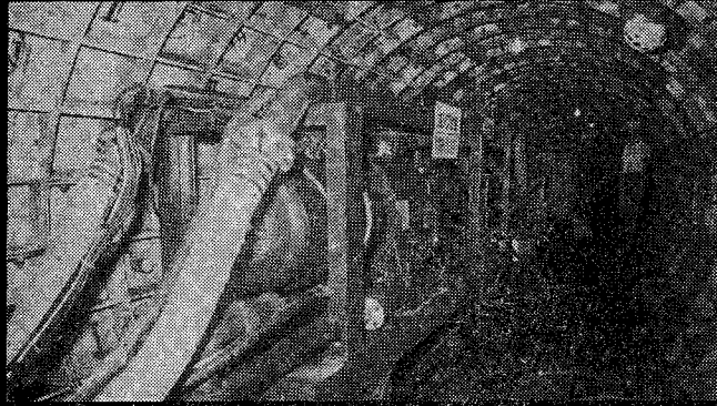
加圧送排泥設備(ポンプ台車)
