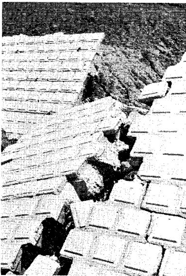
写真—3 道路部盛土の沈壊
