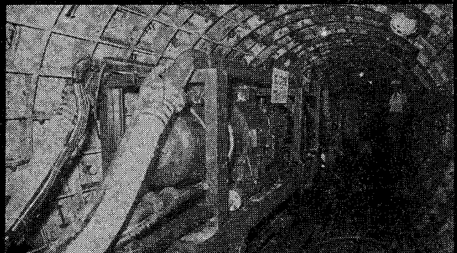
加圧送排泥設備(ポンプ台車)
