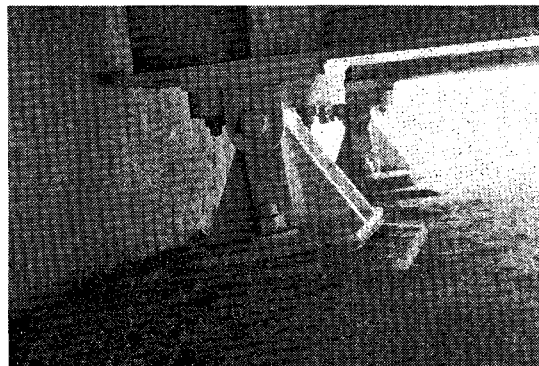
写真二 国道 44 号根室内市・温根沼小橋 (合成桁) の固定くつ浮上り
