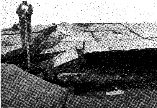
写真-3 花咲港岸壁エプロンの被害
