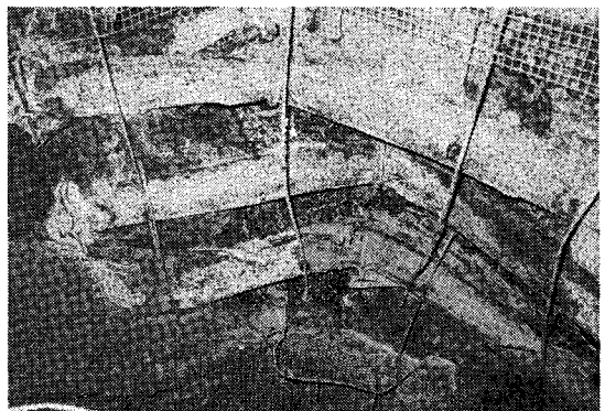
(支保工 No. 10 付近) 写真-2 上半支保工の座屈
