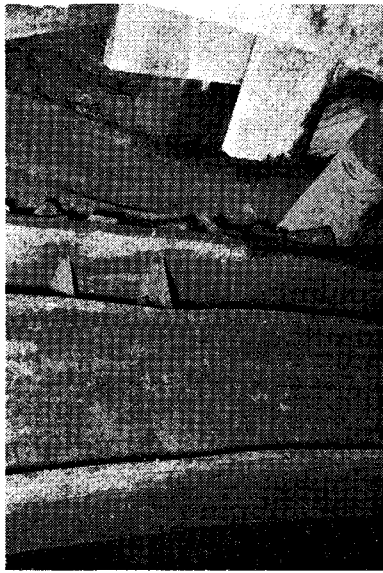
写真-2 中津川方本線トンネル 2.9 km における H-250 鋼アーチ支保工の座屈と二重支保工
