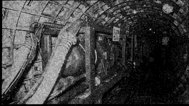
加圧送排泥設備(ポンプ台車)
