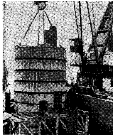
写真-6 200 t 吊り旋回クレーンによって、14 リング (280 t) を圧気を利用して設置している状況
