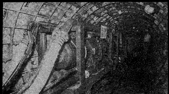
加圧送排泥設備(ポンプ台車)
