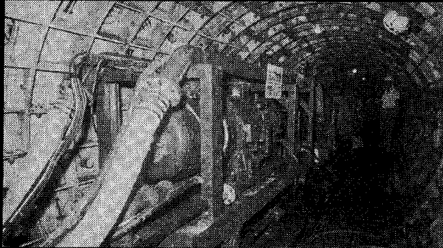
加圧送排泥設備(ポンプ台車)
