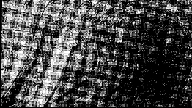
加圧送排泥設備(ポンプ台車)
