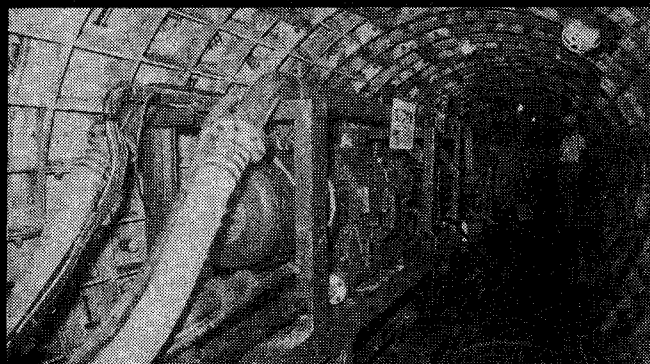
加圧送排泥設備(ポンプ台車)
