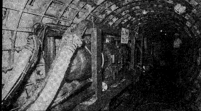
加圧送排泥設備(ポンプ台車)
