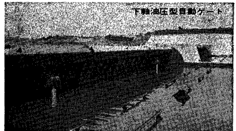
下輪油圧型自動ゲート
