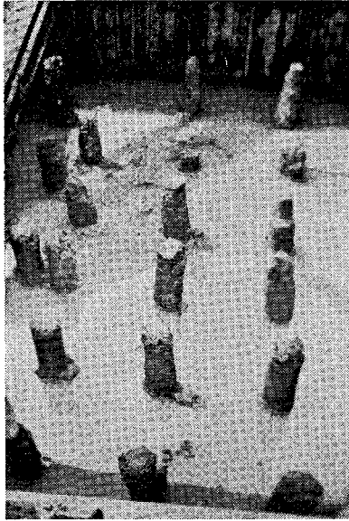
写真—3 腐食した木杭
