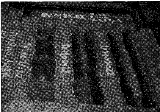
写真-1 ジェット水掘削機によるコンクリートブロックの掘削状況
