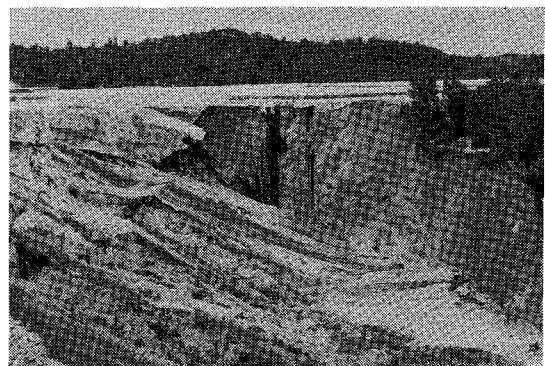
写真-13 台地周縁の溢流崩壊
