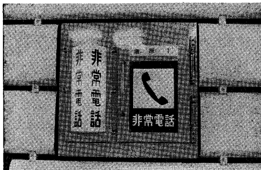
写真-7 蒲原トンネル内の非常電話設置例
