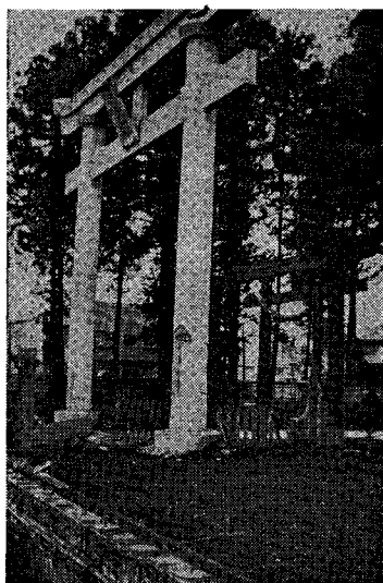
写真-14 被害を生じた十和田市稲荷神社の RC 鳥居
