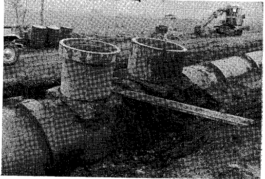
写真-4 大口径ヒューム管浮上がり長軸のまわりに回転
