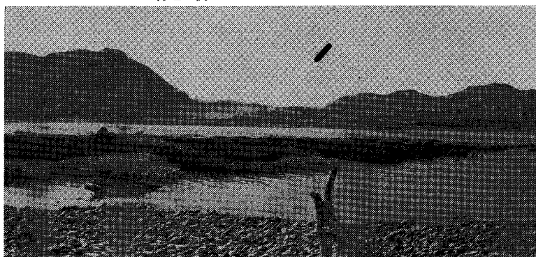
写真-3 河床低下により用水のサイフォンが露出し破損しつつある大野川 18 km 付近の例
