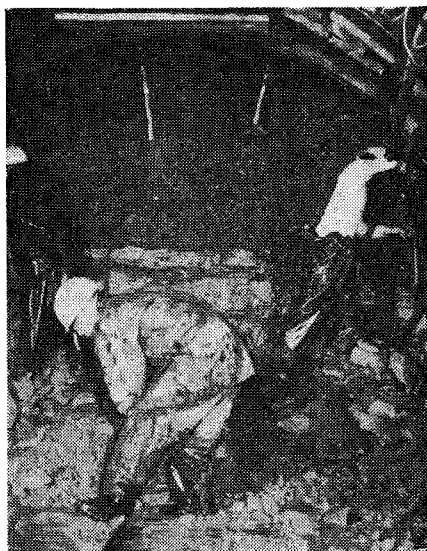
薬液注入により掘削が進められた、 朝霞浄水場導水路底設導坑
