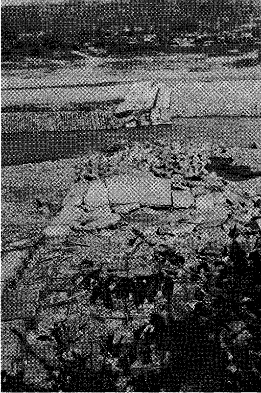
写真-3 真中で折れた小沢頭首工
